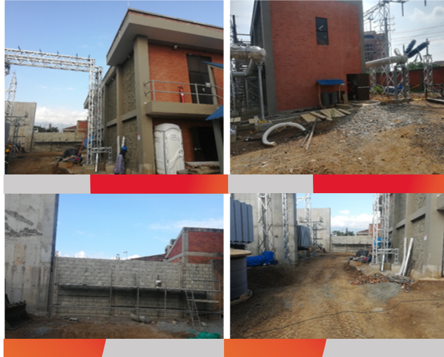
Figura 30. Subestación Diesel II.
